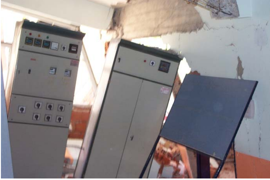
Elektrik Panolarının bağlantılarının standart olarak yapılmaması
