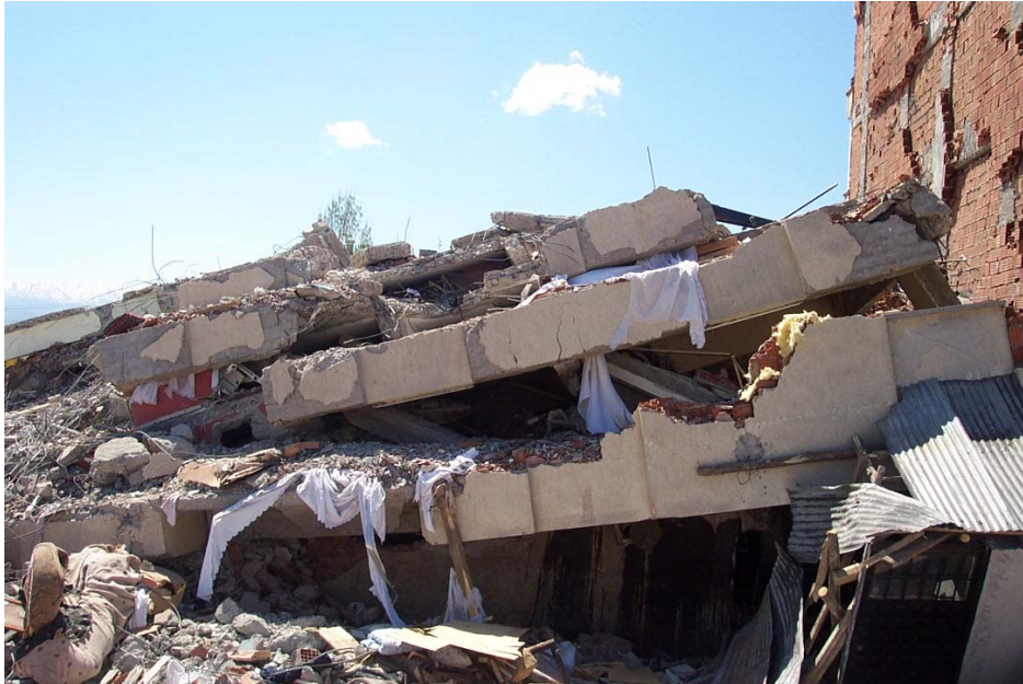
Deprem yönetmeliğine ve standartlara uygun olmadan yapılan bir yapı örneği
