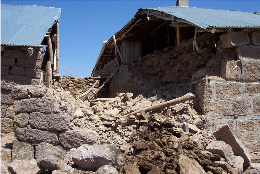
Yığma taş ve kerpiç yapı hasar örnekleri
